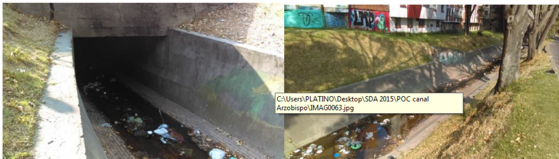
Fotografía No. 3. Residuos sólidos dispuestos sobre el cauce del canal Arzobispo a la altura de la Calle 45.
