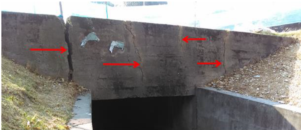
Fotografía No. 2. Muro de contención sobre el canal Arzobispo el cual presenta un avanzado estado de deterioro.
